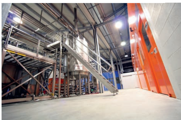
Impianto di produzione del lievito naturale Atecnos: la sterilità assoluta del processo produttivo è dietro alle porte arancioni e blu, che danno accesso alle camere bianche aseptiche
